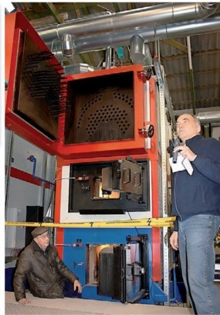
Bernd Riehl (kleines Bild, links) unterstützte Pfarrer a.D. Wilhelm Gerlach bei der Segnung der Nahwärmezentrale. Dr. Volker Seumer (rechts) erläuterte die Funktionsweise der Anlagen – hier eines Holzhack-schnitzelkessels.
